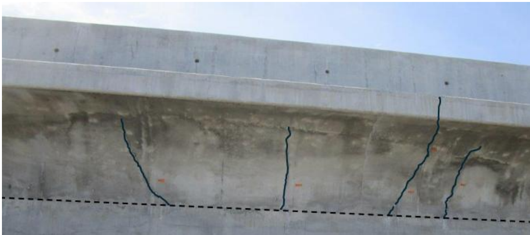
Figure 8 : Exemple de fissures (surlignées en bleu) sur le déflecteur d'un mur chasse-mer – le pointillé représente la reprise de bétonnage entre la partie courante du voile et le déflecteur. Le retrait thermique du déflecteur après prise est gêné par le mur déjà coulé. Les fissures démarrent au niveau de la reprise de bétonnage et se localisent préférentiellement sur les trous de tiges, siège de concentration locale de contraintes.
