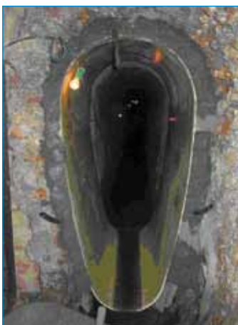
Réhabilitation d'ovoïde par éléments préfabriqués. Coques avec espace annulaire injecté. ©Structure & Réhabilitation.
