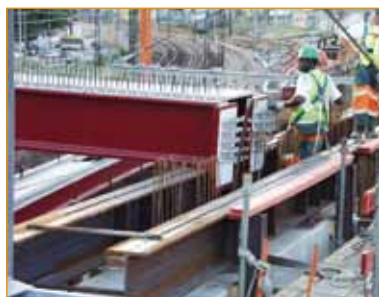
Pont de Choisy Rabotage par platine d'about connectée à un chevtre béton.
