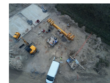
Essais en vraie grandeur de chargement de dallages et semelles sur inclusions rigides
