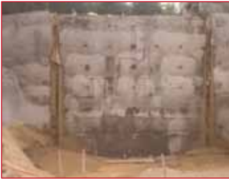
Rupture du mur expérimental n°1 du Cebtp.
