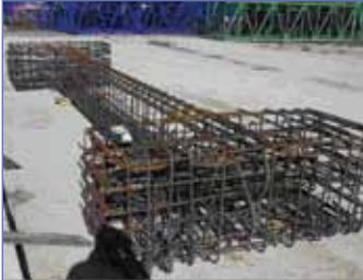
Essais CEOS.fr - Bloc prismatique en retrait gêné avant coulage.
