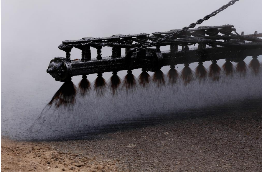
Source COLAS : rampe d'émulsion
