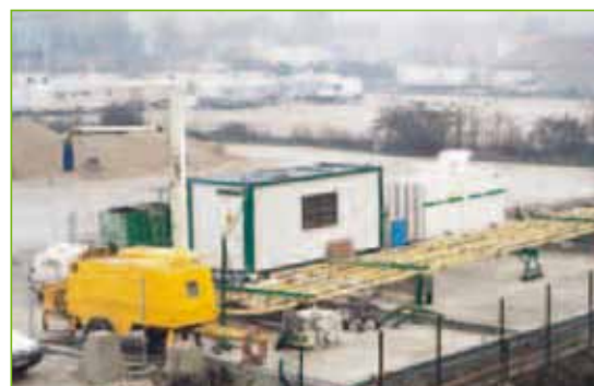
Station d'essais de pompage.
